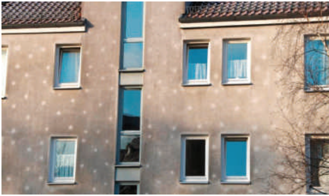
De tels spectres peuvent apparaître en façade lorsque les chevilles sont inadaptées : têtes de cheville „en bosse“ ou conductivité thermique trop élevée
